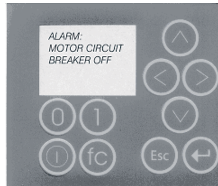
Komplette Information am Display des Schaltkastens.
